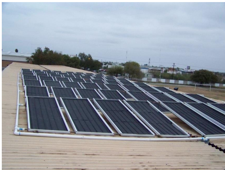
Figura 13.4 Colector solar formado por 60 paneles
